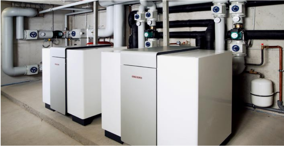
Das Wärmegesetz fördert Wärmepumpen, sofern sie eine bestimmte Jahresarbeitszahl erreichen.
